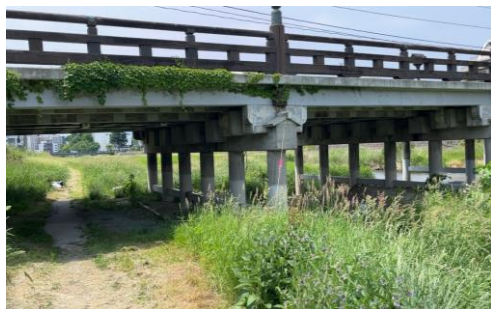
写真7 人の往来がある高架下に散乱ごみが集中
